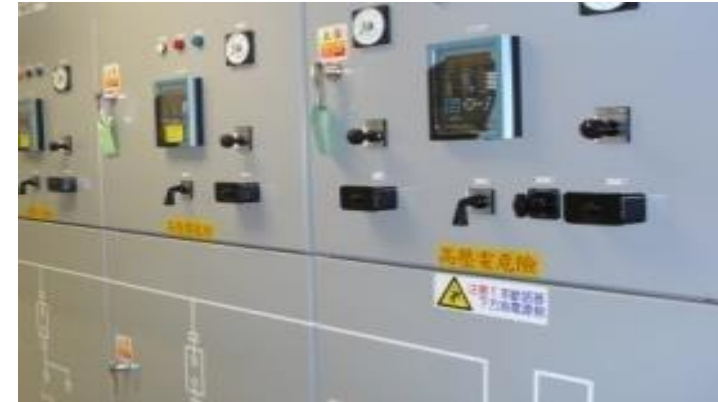
確認高壓配電盤
