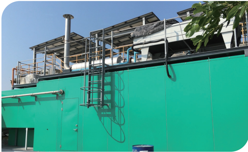
圖 3 沼氣供應發電系統進行發電
